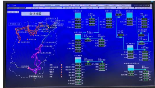
【中央監視システム】
