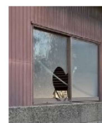
窓が割れた管理不全空家
